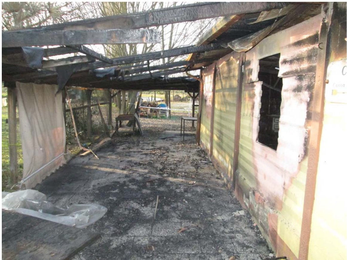
PERGOLATO ESTERNO COMPLETAMENTE BRUCIATO
