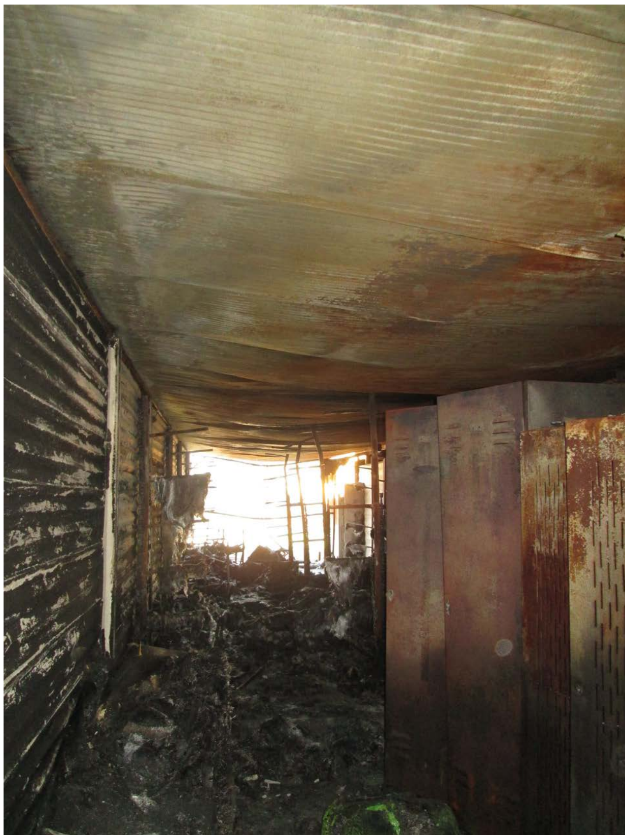
ALL'INTERNO DEL LOCALE RIMESSAGGIO LE CANOE DISPOSTE SULLE RASTRELLIERE SONO COMPLETAMENTE BRUCIATE LA COPERTURA IN PANNELLI HA CEDUTO
