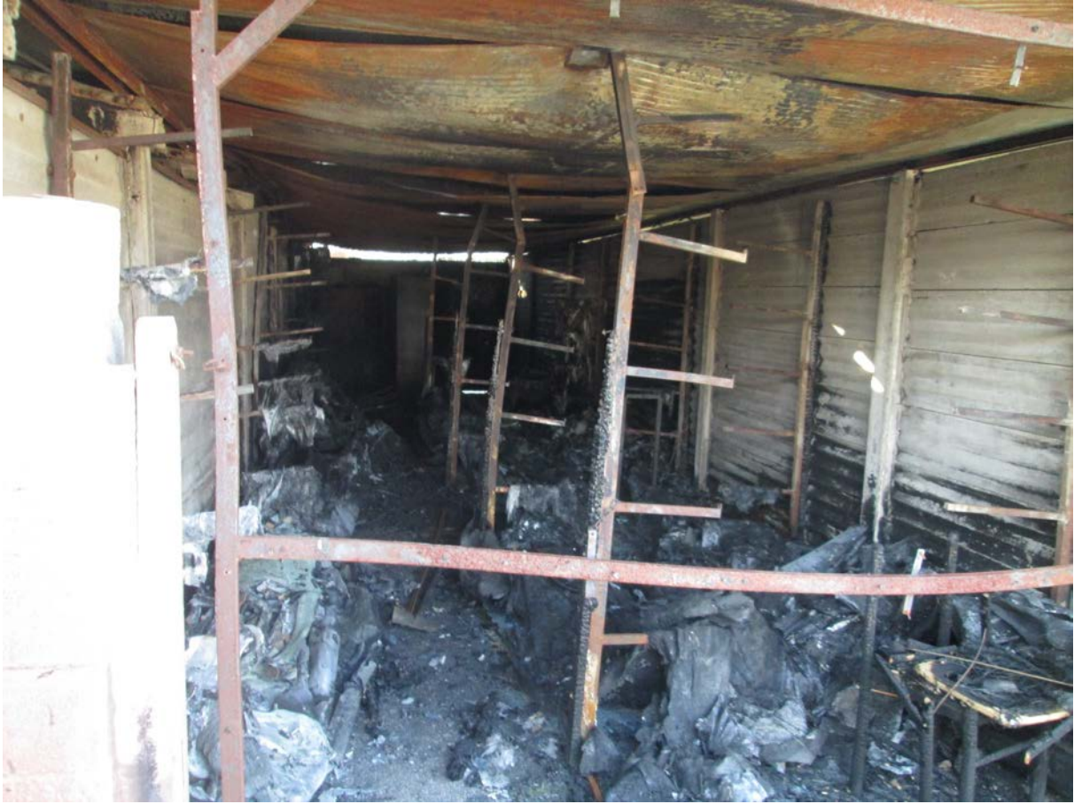
ALL'INTERNO DEL LOCALE RIMESSAGGIO LE CANOE DISPOSTE SULLE RASTRELLIERE SONO COMPLETAMENTE BRUCIATE LA COPERTURA IN PANNELLI HA CEDUTO
