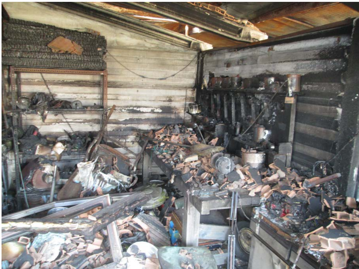
ALL'INTERNO DEL LOCALE MANUTENZIONE HA CEDUTO IL CONTROSOFFITTO IN LATERIZIO – ATTREZZI DA LAVORO E STRUMENTI COMPLETAMENTE INUTILIZZABILI
