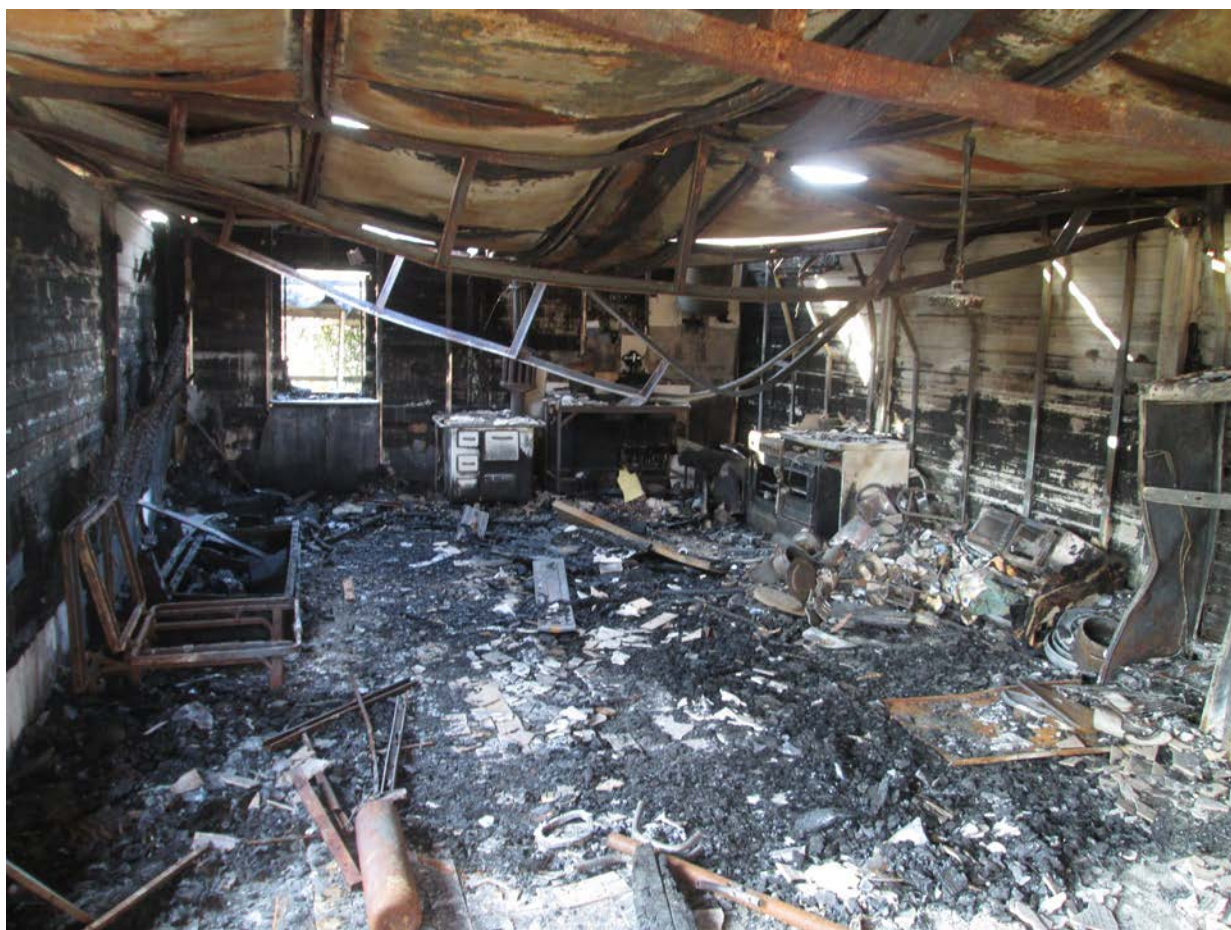
ALL'INTERNO DEL LOCALE SPAZI COMUNI ARREDAMENTO ED ATTREZZATURE SONO COMPLETAMENTE BRUCIATE LA COPERTURA IN PANNELLI HA CEDUTO
