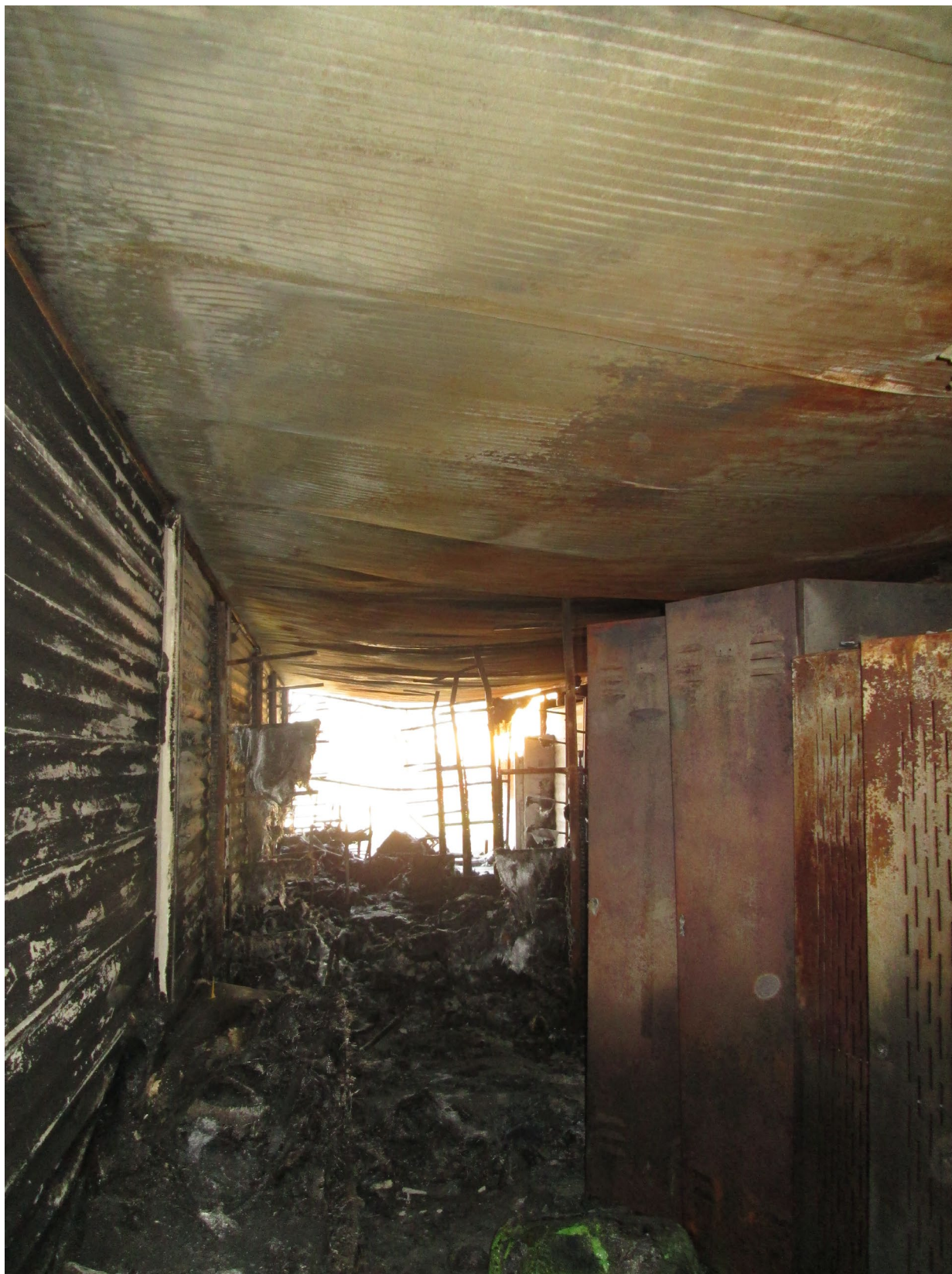
ALL'INTERNO DEL LOCALE RIMESSAGGIO LE CANOE DISPOSTE SULLE RASTRELLIERE SONO COMPLETAMENTE BRUCIATE LA COPERTURA IN PANNELLI HA CEDUTO
