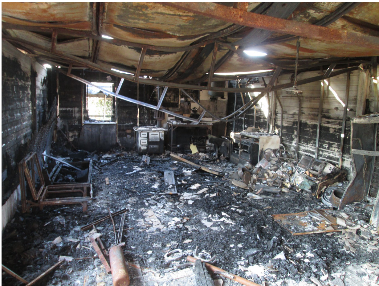
ALL'INTERNO DEL LOCALE SPAZI COMUNI ARREDAMENTO ED ATTREZZATURE SONO COMPLETAMENTE BRUCIATE LA COPERTURA IN PANNELLI HA CEDUTO
